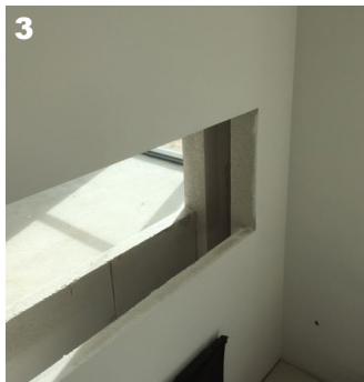
3 Pejsevæggen er ikke sikret mod falsk træk i siderne / The fireplace wall is not secured against false draft in the sides.
